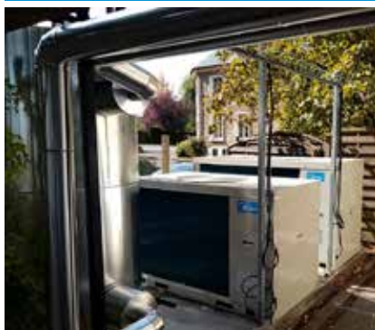
Lieu : Versailles Unités extérieures : Chillers
