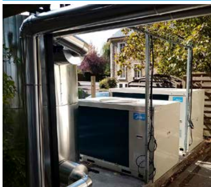
Lieu : Versailles Unités extérieures : Chillers
