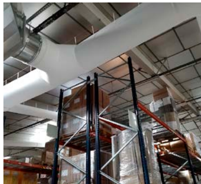
Lieu : Rennes Équipements installés : VRF, Gainables
